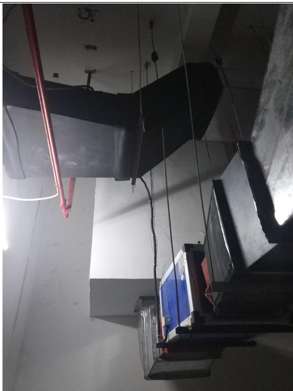
通风系统排风管道
