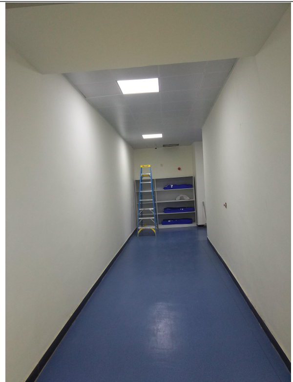
通风系统进风口（位于天花板上）
