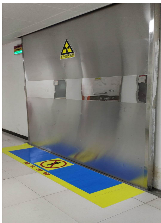
工作状态指示灯及电离辐射警示标识及地面的警示标线
